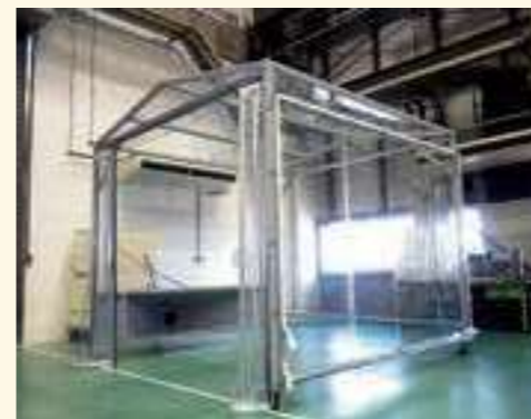
粉塵飛散防止 ビニールシート、D40レール、縦開閉システム使用
